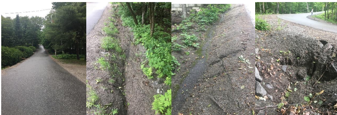
Foyers d'érosion dans le bassin versant du lac Fournelle
